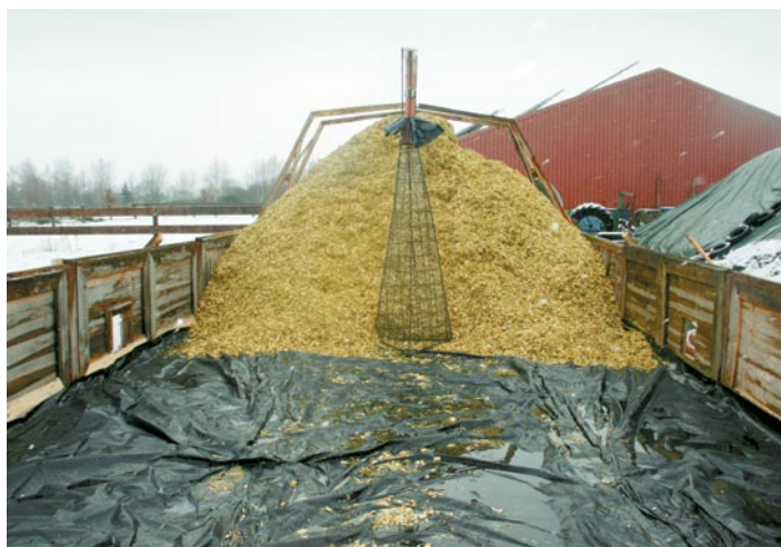
Auf dem Betrieb Flessner wurde dieses Dombelüftungsverfahren von Dr. Joachim Brummack von der TU Dresden zur Hackschnitzeltrocknung installiert.
